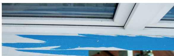
Självhäftande tejp som rivits av upprepade gånger på grund av hög vidhäftningsförmåga på vittrad aluminiumfönsterbräda
