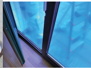
Inget dagsljus, ingen ventilation: komplett täckning med en färgad folie
