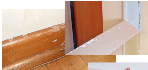
Skador på äldre lacker/färg på grund av för hög vidhäftning
