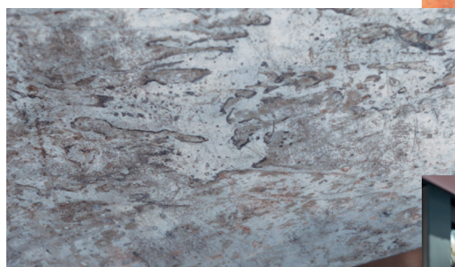
Ytförändring på grund av kondens på zinkplåt
