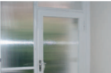
Viele Türen schließen nicht so dicht, wie es scheint
